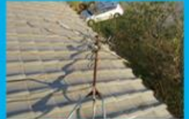
アンテナ倒壊
